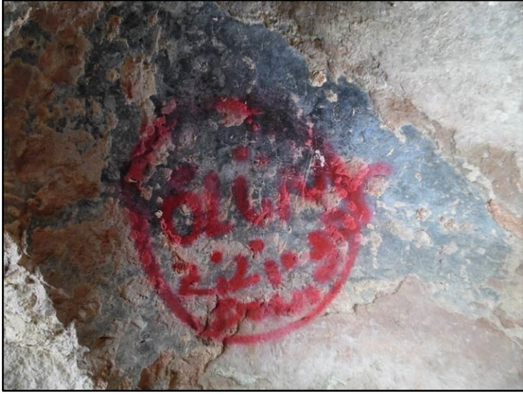
Resim 15: Onarım öncesi görünüm. ( Kaya Kilisesi).
