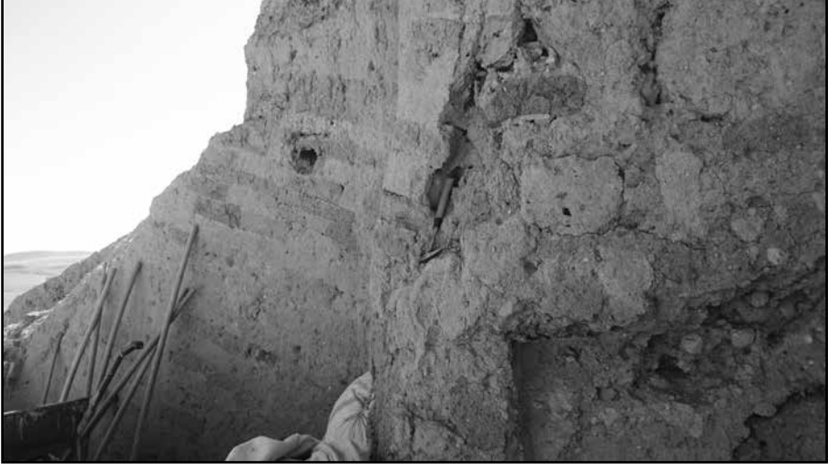
Resim 3: Güney sur duvarlarının yıkılan kerpiç blokları.
