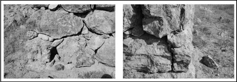
Resim 9: Depremiñ doęu sur duvarları üzerindeki etkileri.
