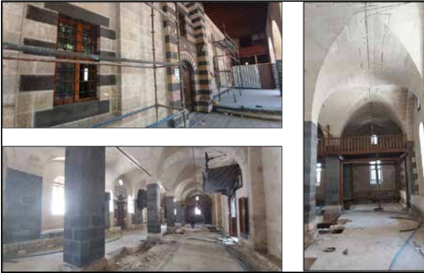
Şekil 1b: Gaziantep Eyüpoğlu Camii'nin Kahramanmaraş depremleri sonrasına ait görüntüler (MAKLAB Arşivi, 14.07.2024)
