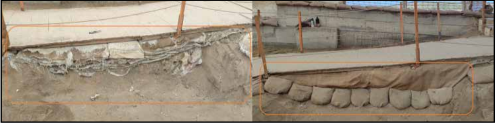
Resim 9: Bina 102 kuzey cephesi destek çalışması öncesi (sol) ve sonrası (sağ) görünümü.
