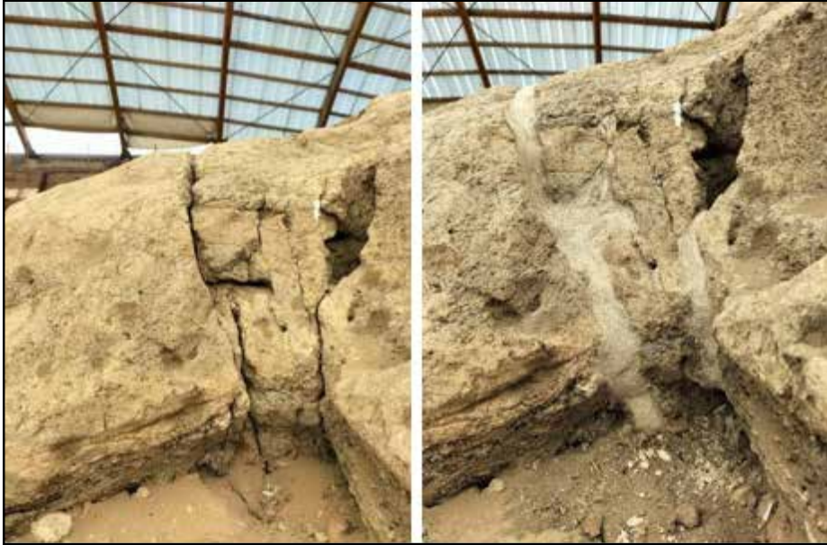
Resim 12: Bina 3 duvar köşesi dolgu öncesi çatlakların (sol) ve dolgu çalışması sonrası (sağ) görünümü.
