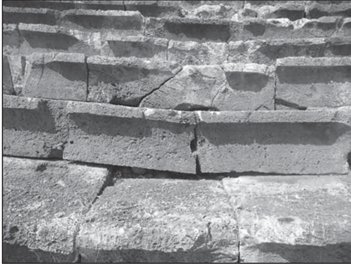
Resim 4: Kaş Tiyatrosu'nda caveada görülen bozulmalardan; statik etki veya tektonik etki sonucu görülen taş kırılmaları.
