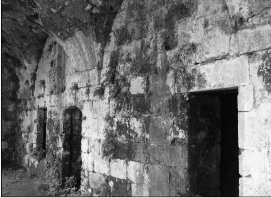
Resim 6: Pallas Sokullu Külliyesi, imaret kısmı biyolojik oluşum
