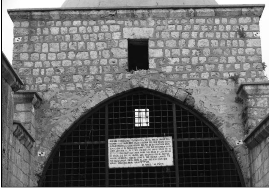
Resim 9: Pallas Sokullu Külliyesi, arasta kısmı giriş cephesi, çimento içerikli onarım harçları
