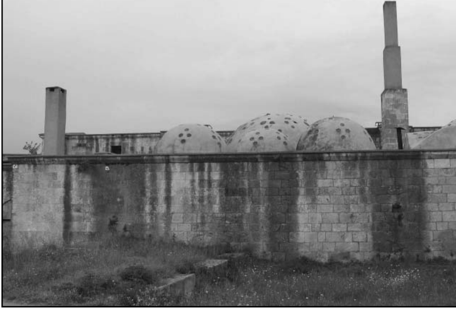
Resim 5: Pallas Sokullu Külliyesi, hamam kısmı batı cephe, siyah tabaka oluşumu
