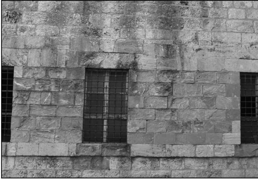
Resim 10:Pallas Sokullu Külliyesi, hamam kısmı güney duvarı, bozulmuş onarım taşları
