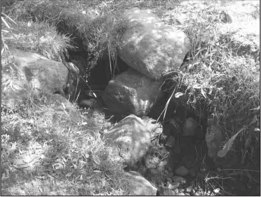
Resim 15: Yukarı Pay Kanalı'nın yıkılan destek duvarları
