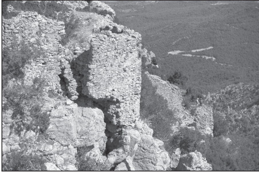
Abb. 10: MYK 65. Fındıklı Kale. Erdbebenschäden im Bereich des Zwinger
