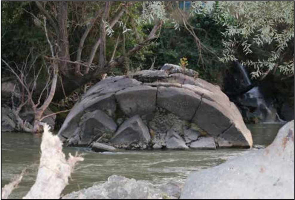
Resim 4: Mauricius Köprüsü, Sakarya Nehri üzerinde yıkılmış bir ayak kalıntısı.
