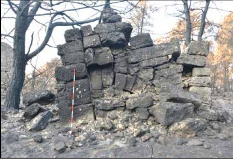
Resim 6: Yangın sonrası acil mimari belgeleme çalışmaları kapsamında duvar cephe ve kesitlerinin belgelenmesi.
