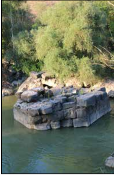
Resim 3: Mauricius Köprüsü, Sakarya Nehri üzerinde yıkılmış bir ayak kalıntısı.
