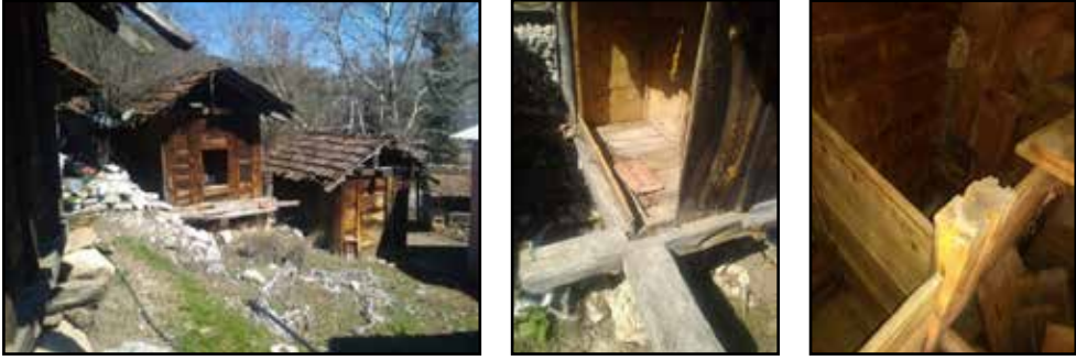
Şekil 8: Antalya Sinan Değirmeni Silolarının Genel Görünüşü ve Deformasyona Uğramış Kısımları
